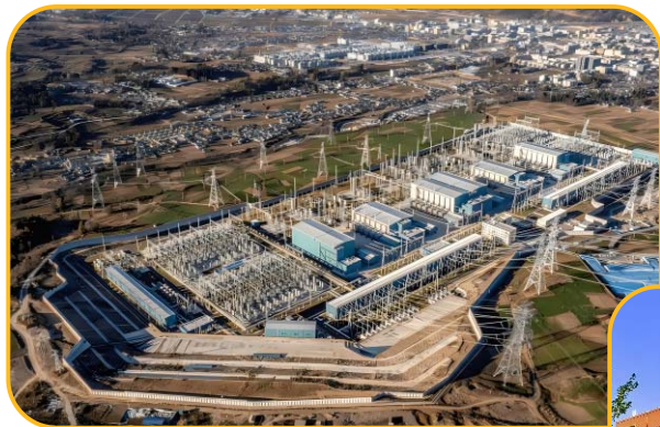
四川省布拖县±800kV换流站
