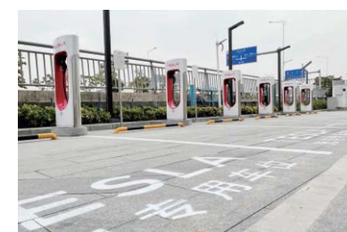
园区新能源汽车充电设备
