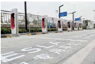
园区新能源汽车充电设备
