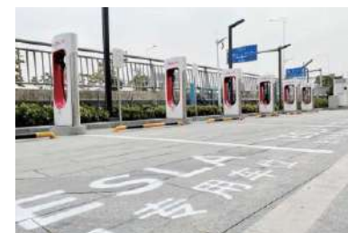
园区新能源汽车充电设备
