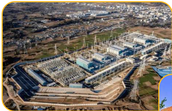
四川省布拖县±800kV换流站
