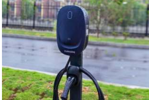
广东某地公交充电站
