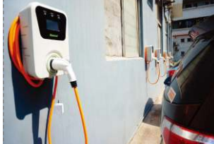
深圳西丽充电站
