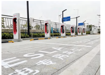
园区新能源汽车充电设备
